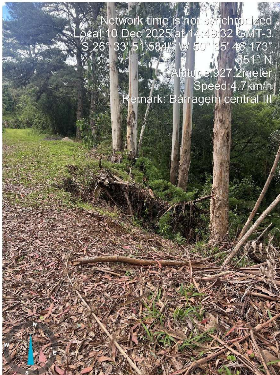
Figura 43 PERDA DE TALUDE
