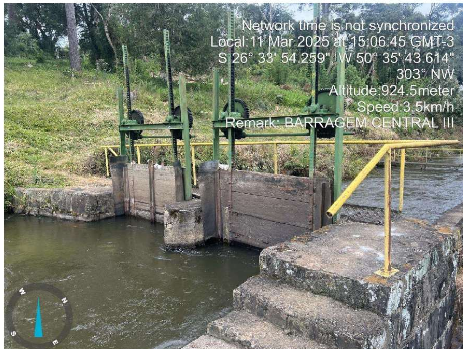
Figura 16 COMPORTA PARA CONTROLE DE ÁGUA
