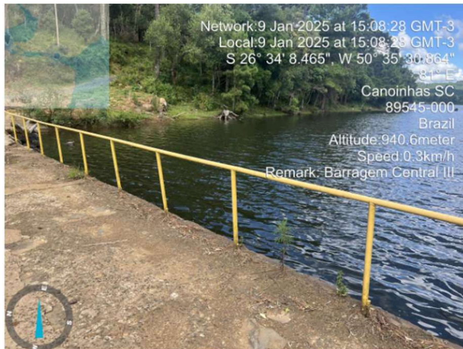
Figura 53 RESERVATÓRIO LADO DIREITO
