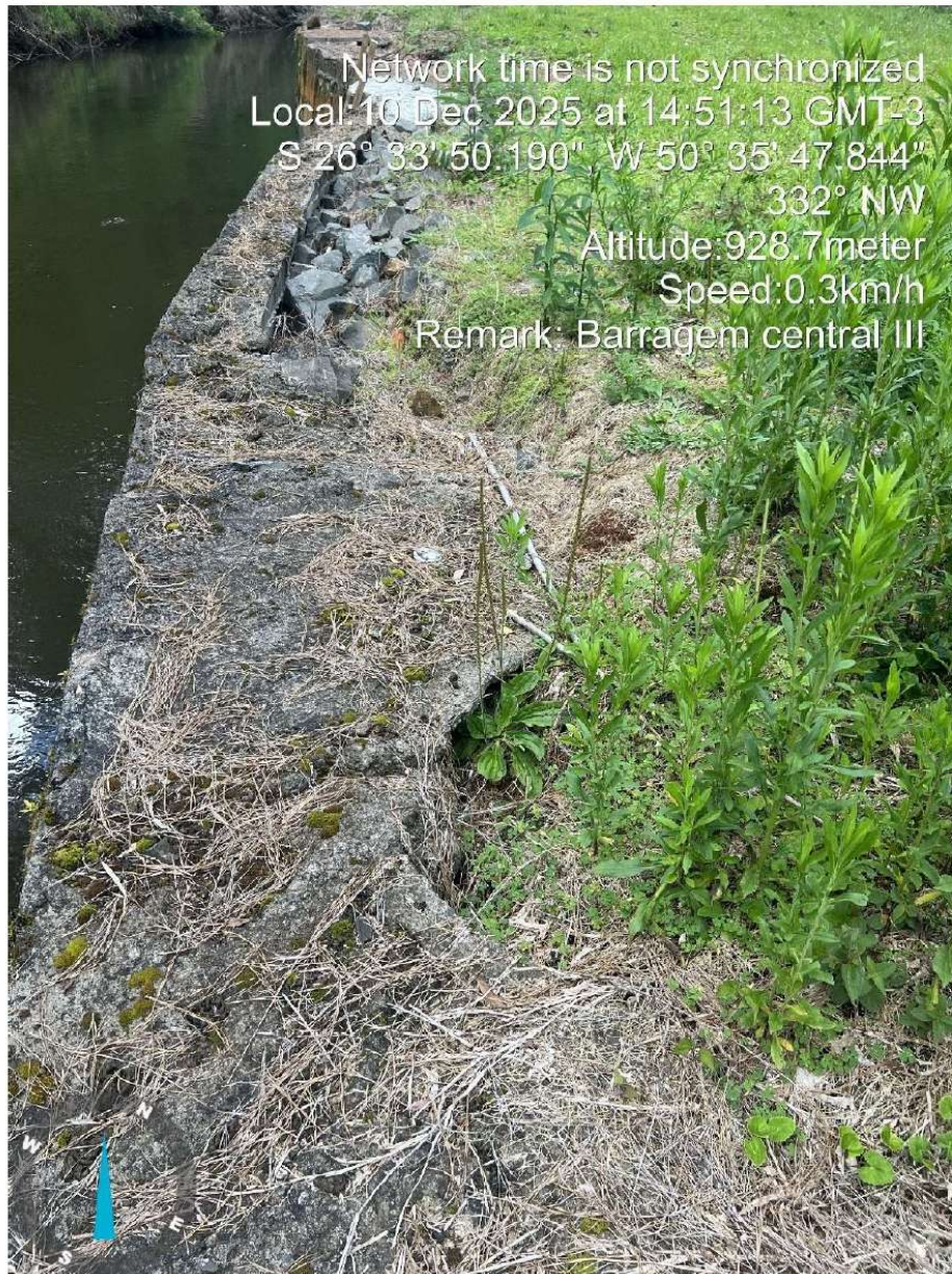
Figura 49 DESLIZAMENTO DE TALUDE COM DESCOLAMENTO DE PARAMENTO
