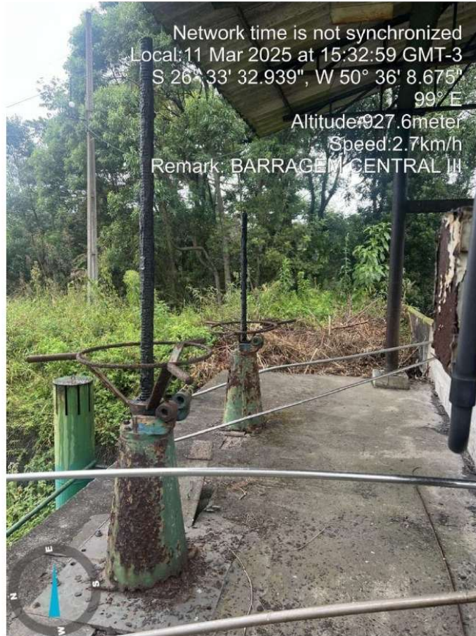
Figura 60 OXIDAÇÃO EM ESTAGIO AVANÇADO
