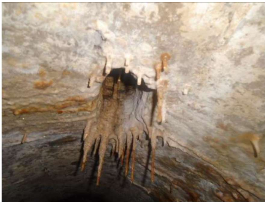
Figura 33 DRENO PARA A GALERIA ENTUPIDO
