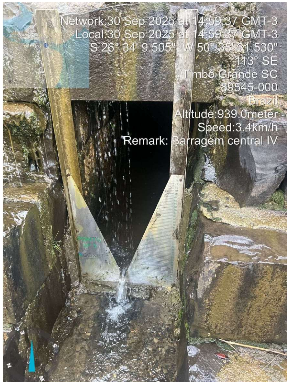
Figura 30 MEDIDOR VAZÃO GALERIA
