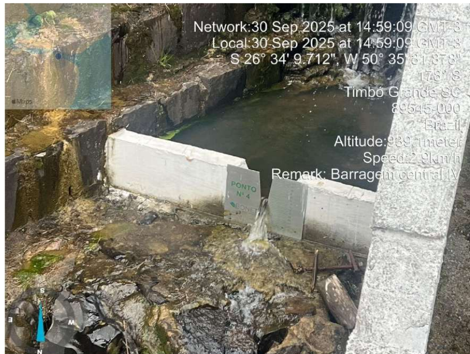
Figura 42 MEDIDOR DE VAZÃO 04
