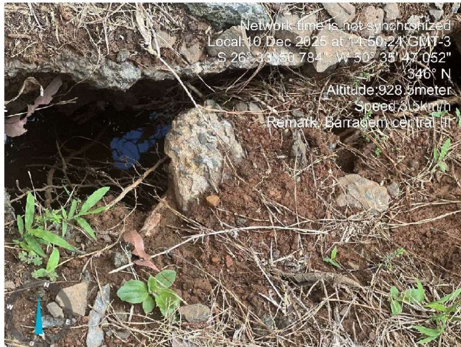
Figura 30 DESLIZAMENTO DE TALUDE COM ESTADO AVANÇADO DE INFILTRAÇÃO
