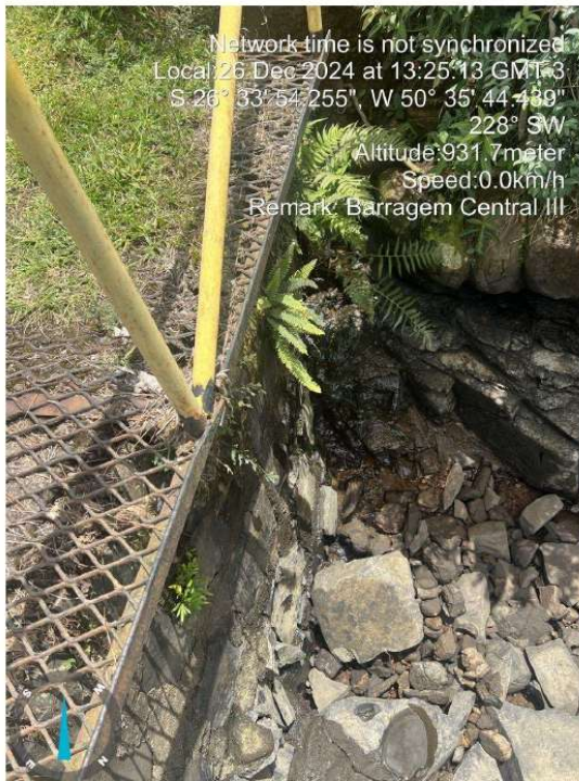
Figura 19 SURGÊNCIAS NO ENTOCAMENTO BLOCO DE PEDRA ARGAMASSADA E ATERRO CANAL
