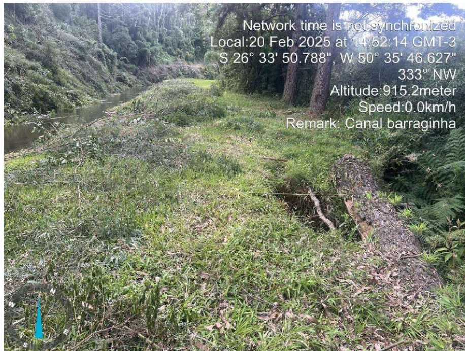
Figura 55 TALUDE COM INICIO DE DESMORONAMENTO
