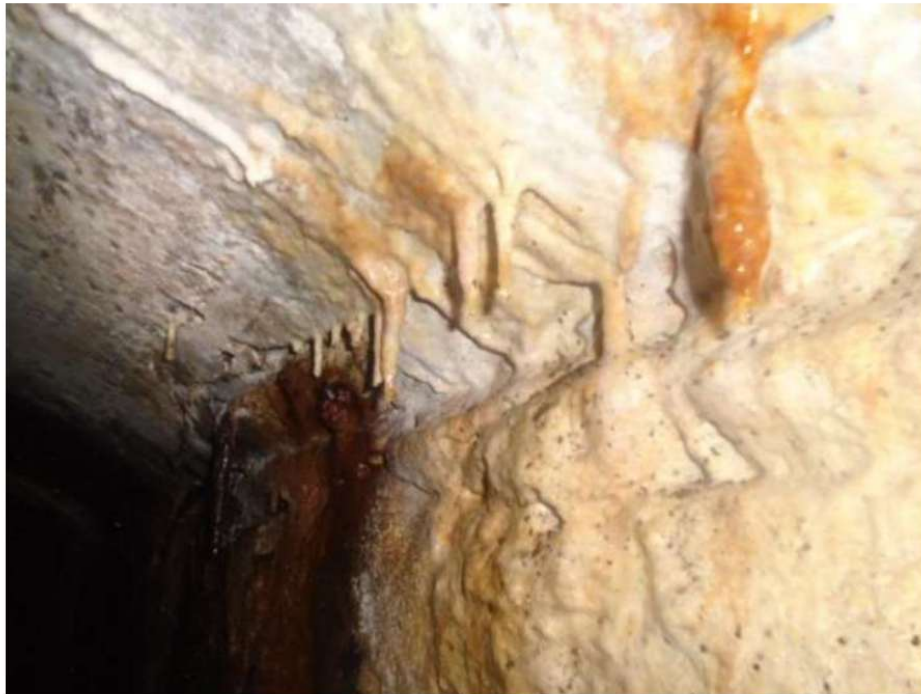
Figura 35 SINAIS DE CARBONATAÇÃO
