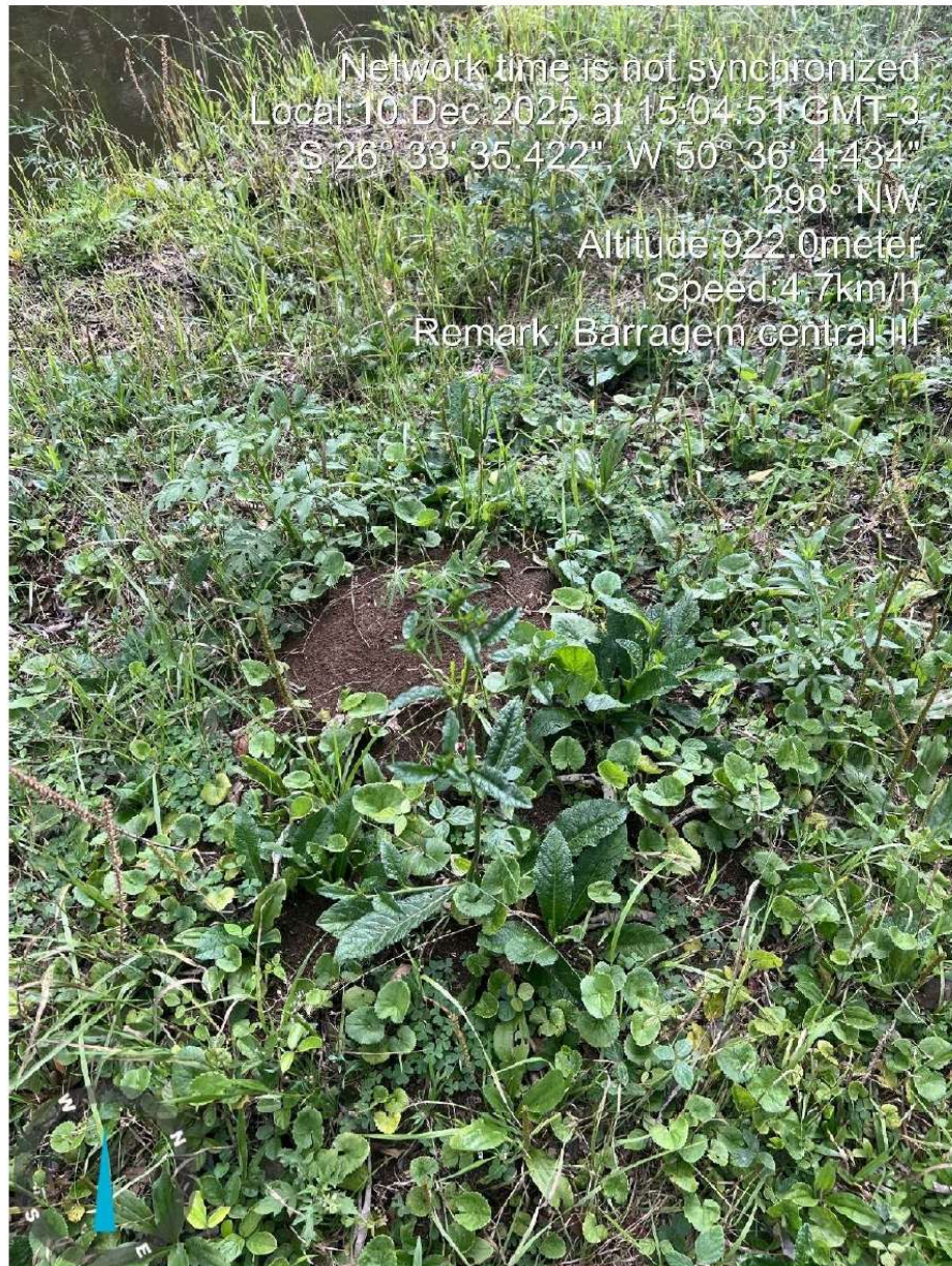
Figura 27 FORMIGUEIRO FACILITANDO A INFILTRAÇÃO DE AGUA
