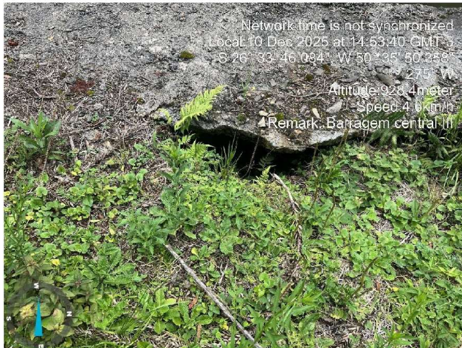
Figura 32 DESLIZAMENTO DE TALUDE
