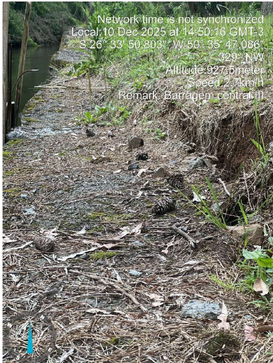
Figura 44 DESLIZAMENTO DO TALUDE
