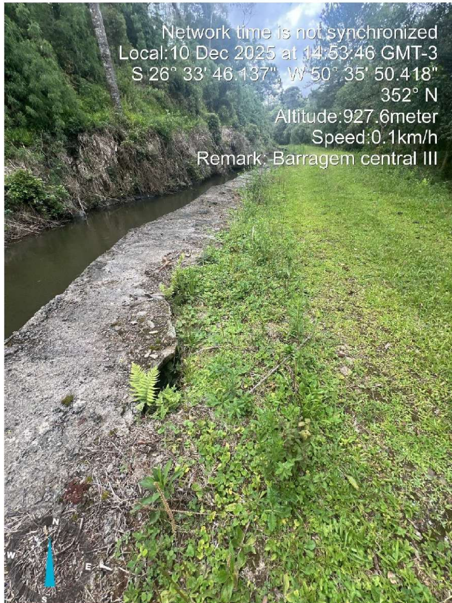
Figura 46 DESLISAMENTO DO TALUDE COM ABERTURA LATERAL
