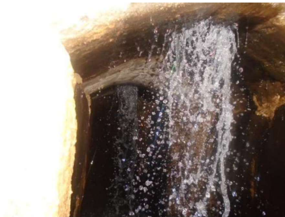
Figura 34 DRENO EM OPERAÇÃO GALERIA
