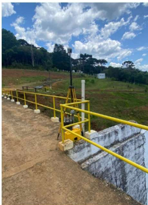
Figura 38 MARCO SUPERFICIAL PARA MEDIÇÃO DE DESLOCAMENTO
