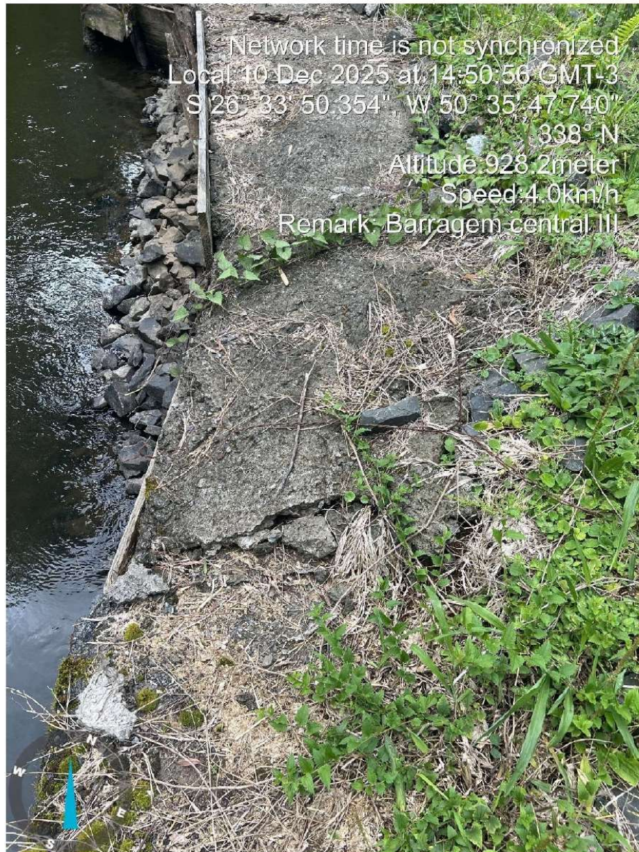
Figura 48 DESLIZAMENTO DE TALUDE COM QUEBRA DE PARAMENTO
