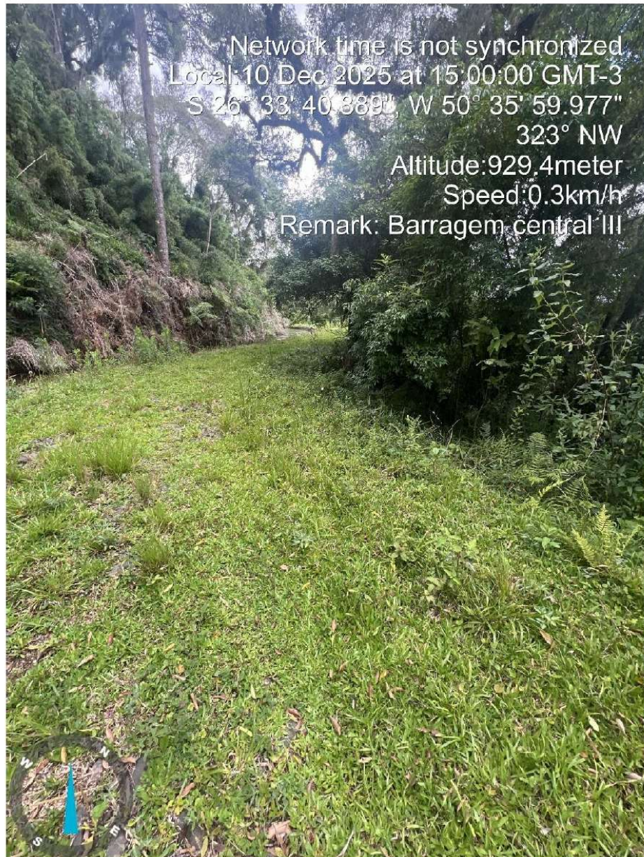
Figura 28 PERDA DE TALUDE
