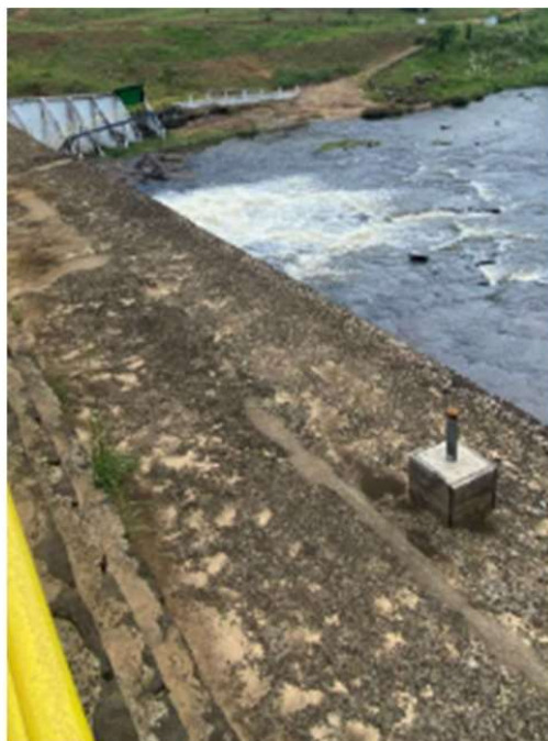
Figura 37 MARCO SUPERFICIAL PARA MEDIÇÃO DE DESLOCAMENTO
