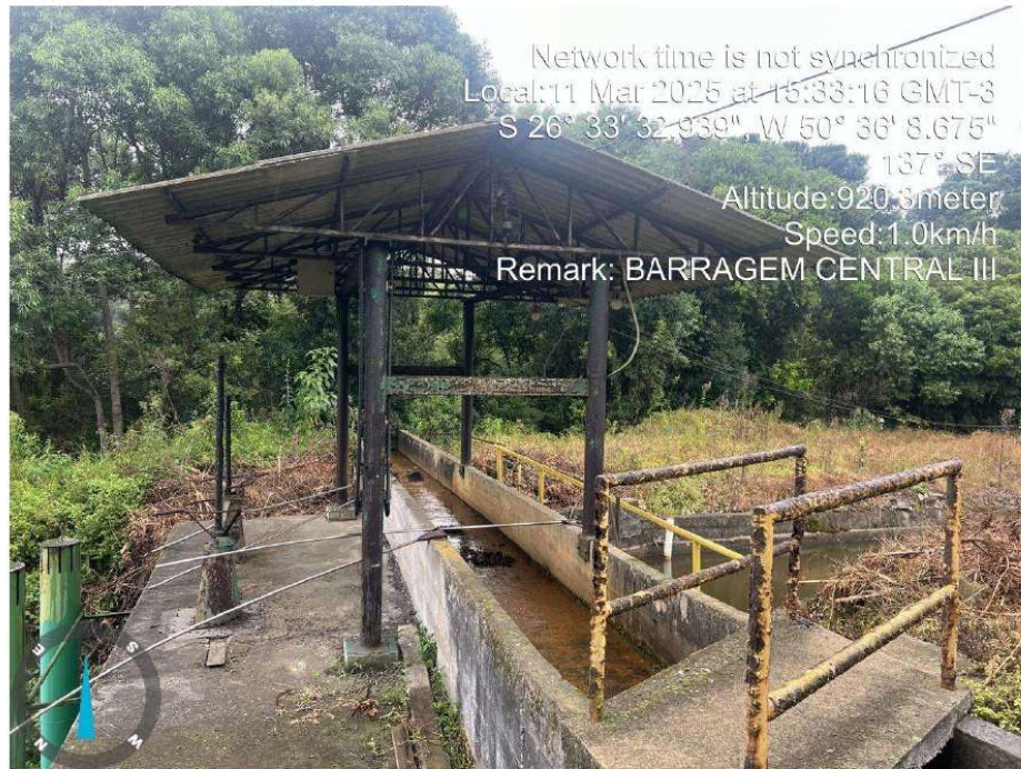
Figura 61 OXIDAÇÃO EM ESTAGIO AVANÇADO PARTE ELETRICA DEPLORAVEL
