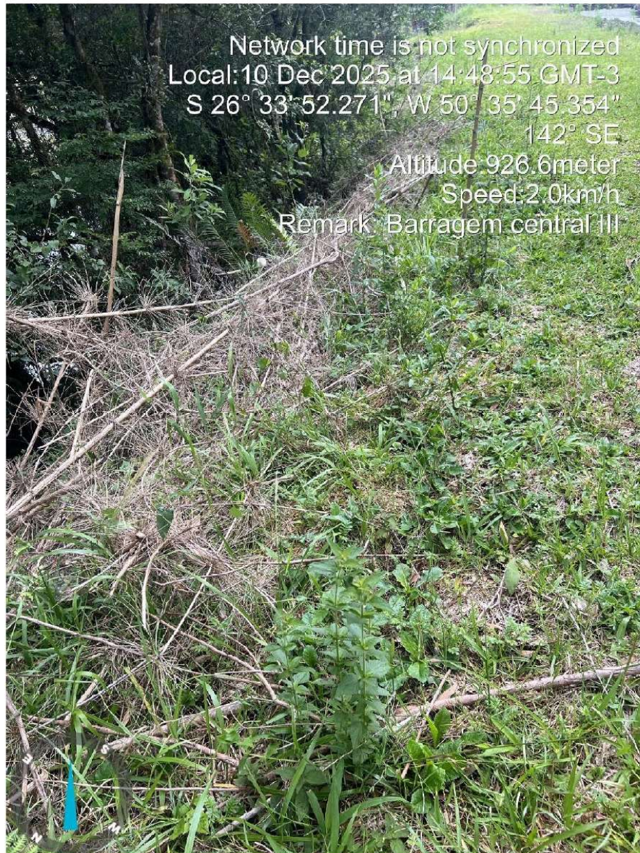
Figura 40 PERDA DE TALUDE
