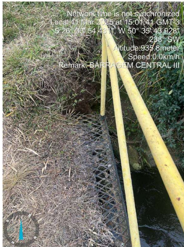
Figura 17 SURGÊNCIAS NO ENTROCAMENTO BLOCO DE PEDRA ARGAMASSADA E ATERRO CANAL
